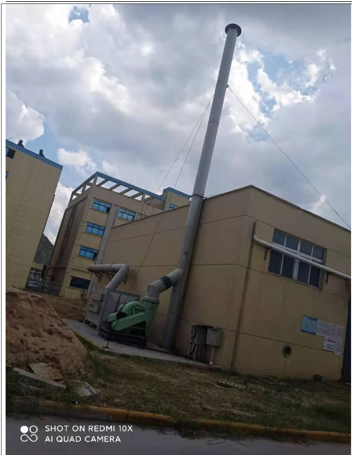
原料仓库废气应急设施
