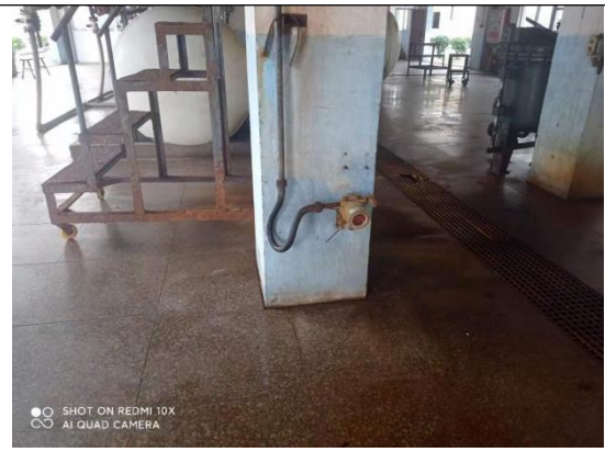
车间可燃气体监测仪
