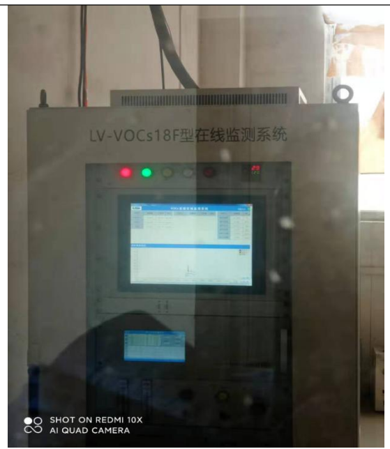
废气在线监测系统
