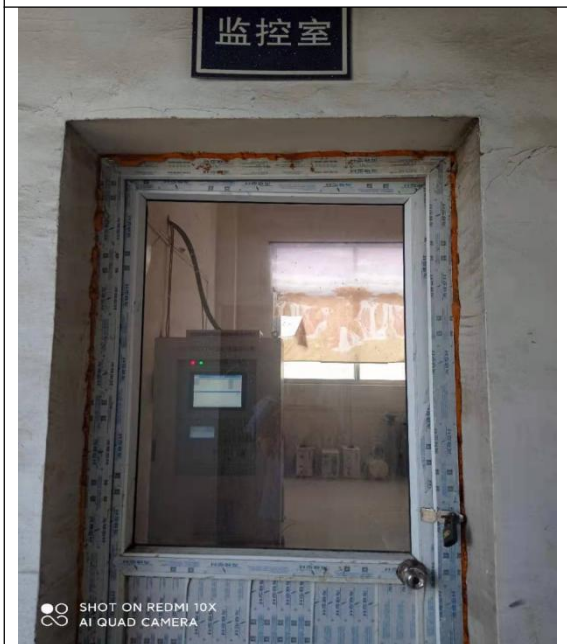
废气在线监控室
