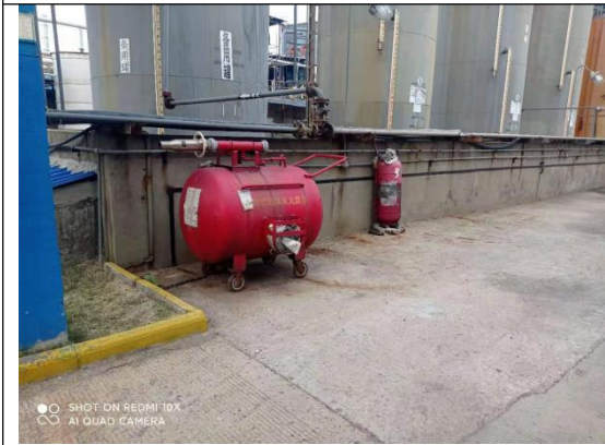
罐区消防设施
