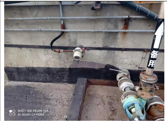
罐区可燃性气体监测仪
