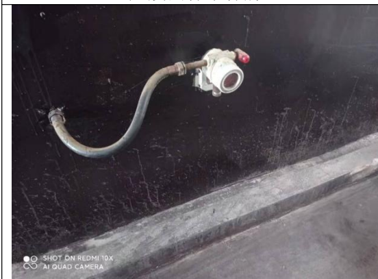
危废间可燃气体监测仪
