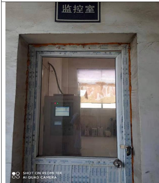
废气在线监控室
