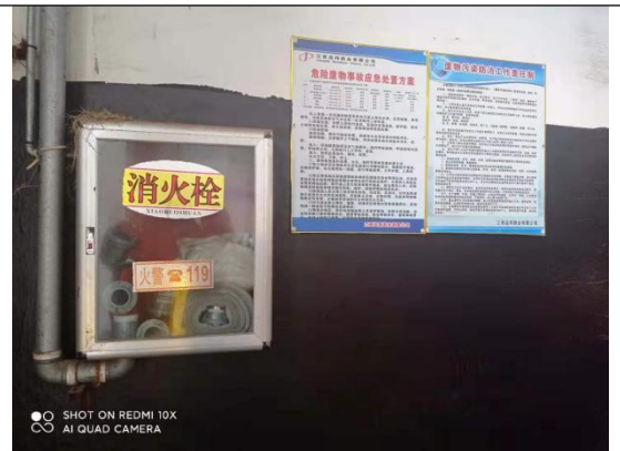
危废间消防设施及应急处置方案信息牌
