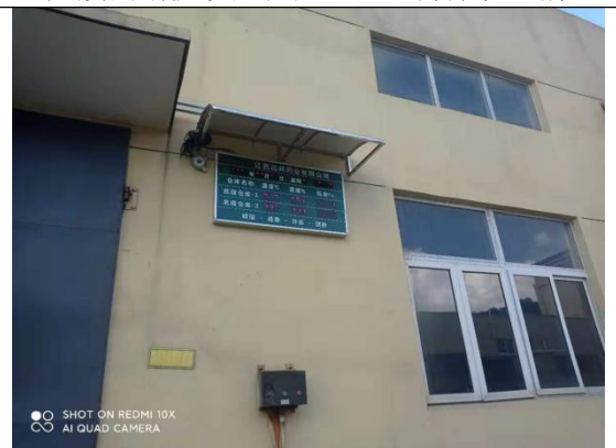
危废间温湿度及压差在线监测
