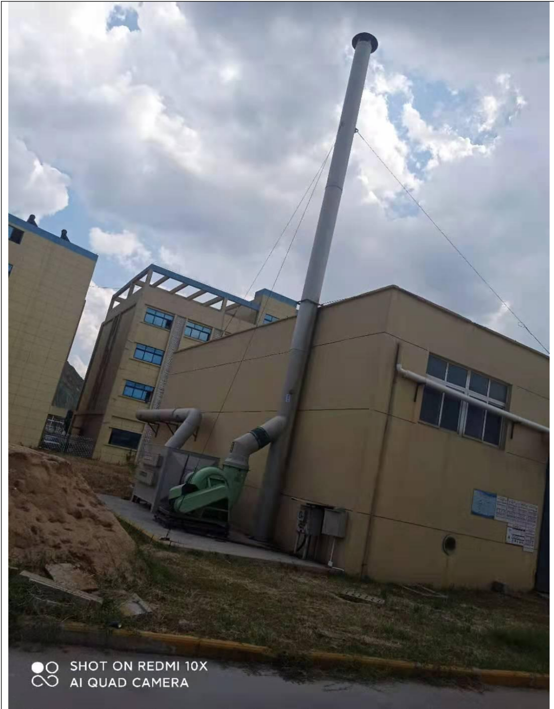
原料仓库废气应急设施
